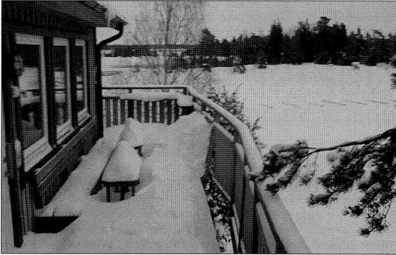
Nedfallande snö har skadat räcket på altanen till servicehuset
